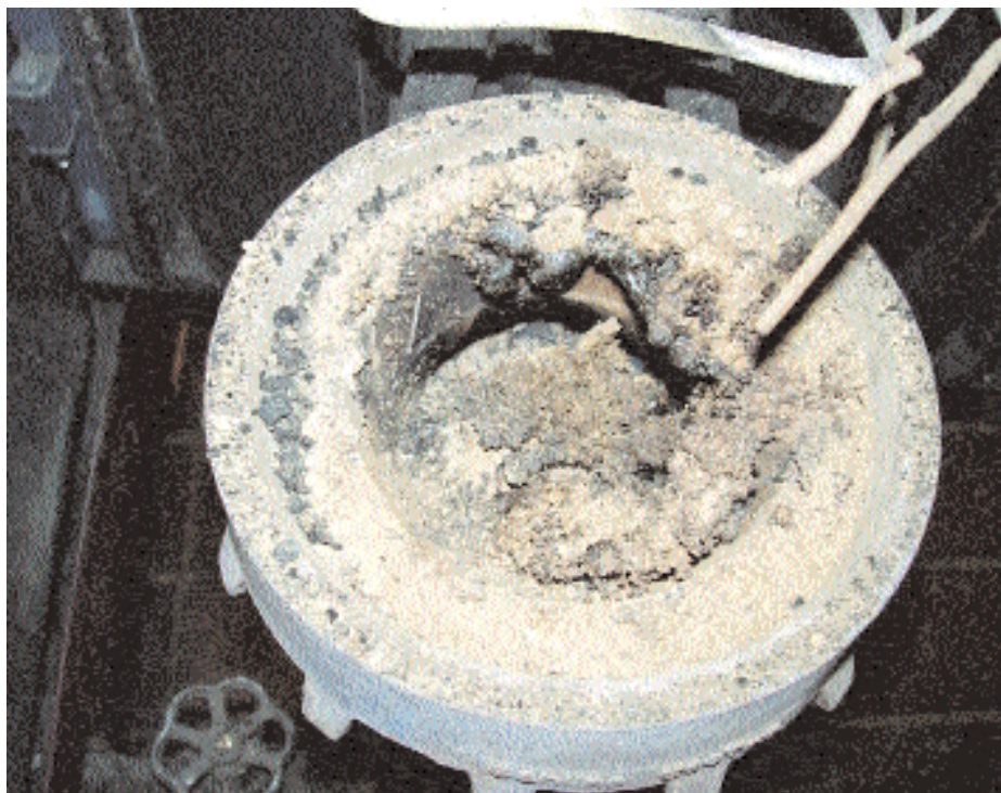
Beläggning av pannor kan uppstå vid eldning av problematiska bränslen, en tillsats av torv kan avhjälpa denna typ av problem.
